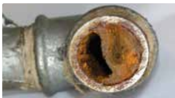
Potrubí s usazeným vodním kamenem
